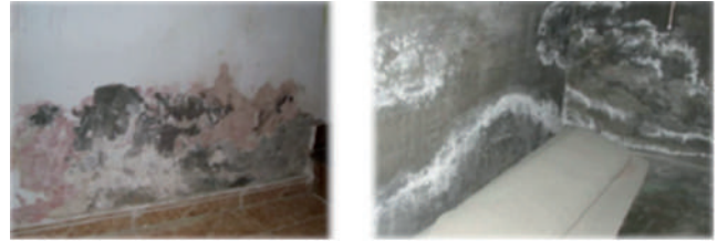
Figura 3. Aparición de eflorescencias superficial en muros
